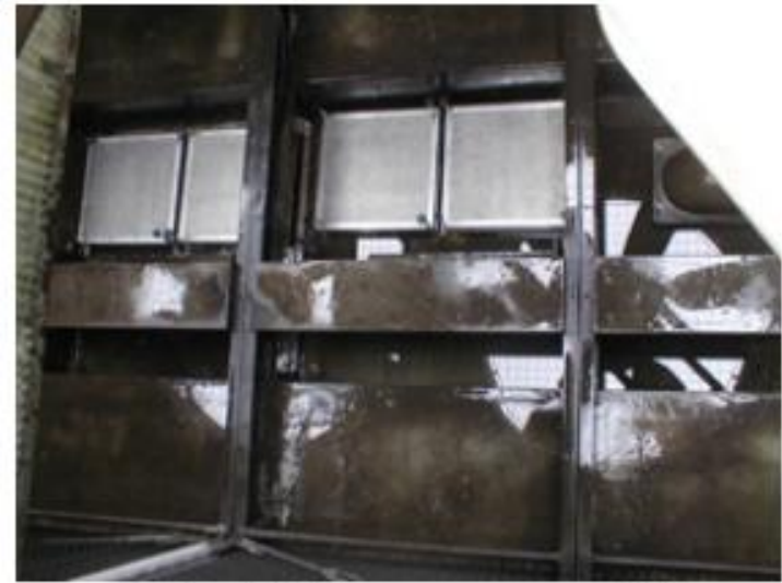
冷却塔下部水槽へGSノンスケールを設置
