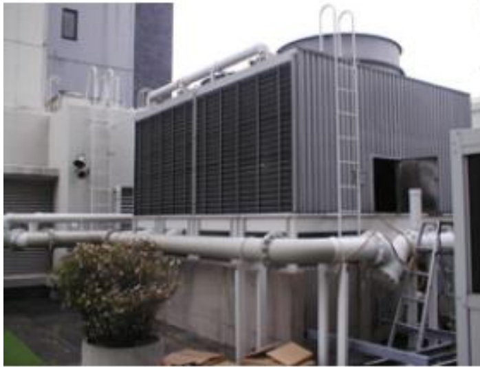
冷却塔(クーリングタワー)
